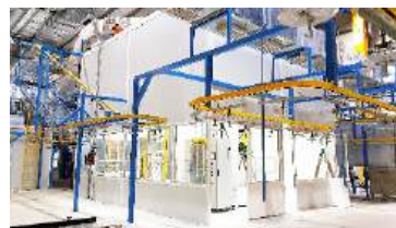
Dây chuyền sơn tĩnh điện bột tự động - Sử dụng máy sơn
