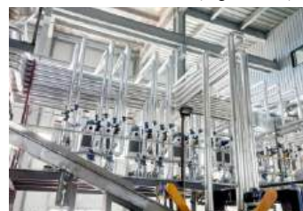
Hệ thống đường ống dẫn nhiệt
