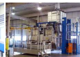
Xử lý khói trạm nấu nhôm
