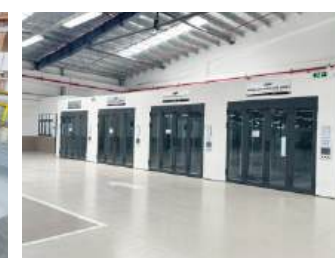
Hệ thống sơn sấy liên hoàn Kiểu Side by Side
