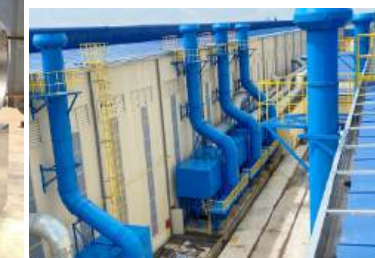
Hệ thống xử lý khí thải dây chuyền sơn Nhà máy Container Hòa Phát
