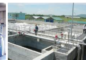
Hệ thống xử lý nước thải cho nhà máy sản xuất pin VinES Hà Tĩnh
